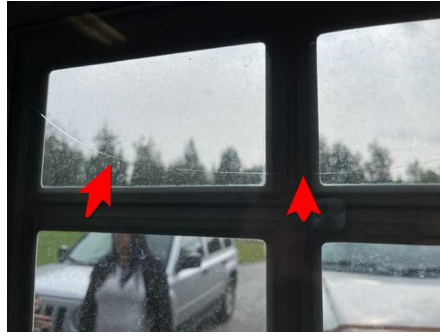
Cracked windows big door
